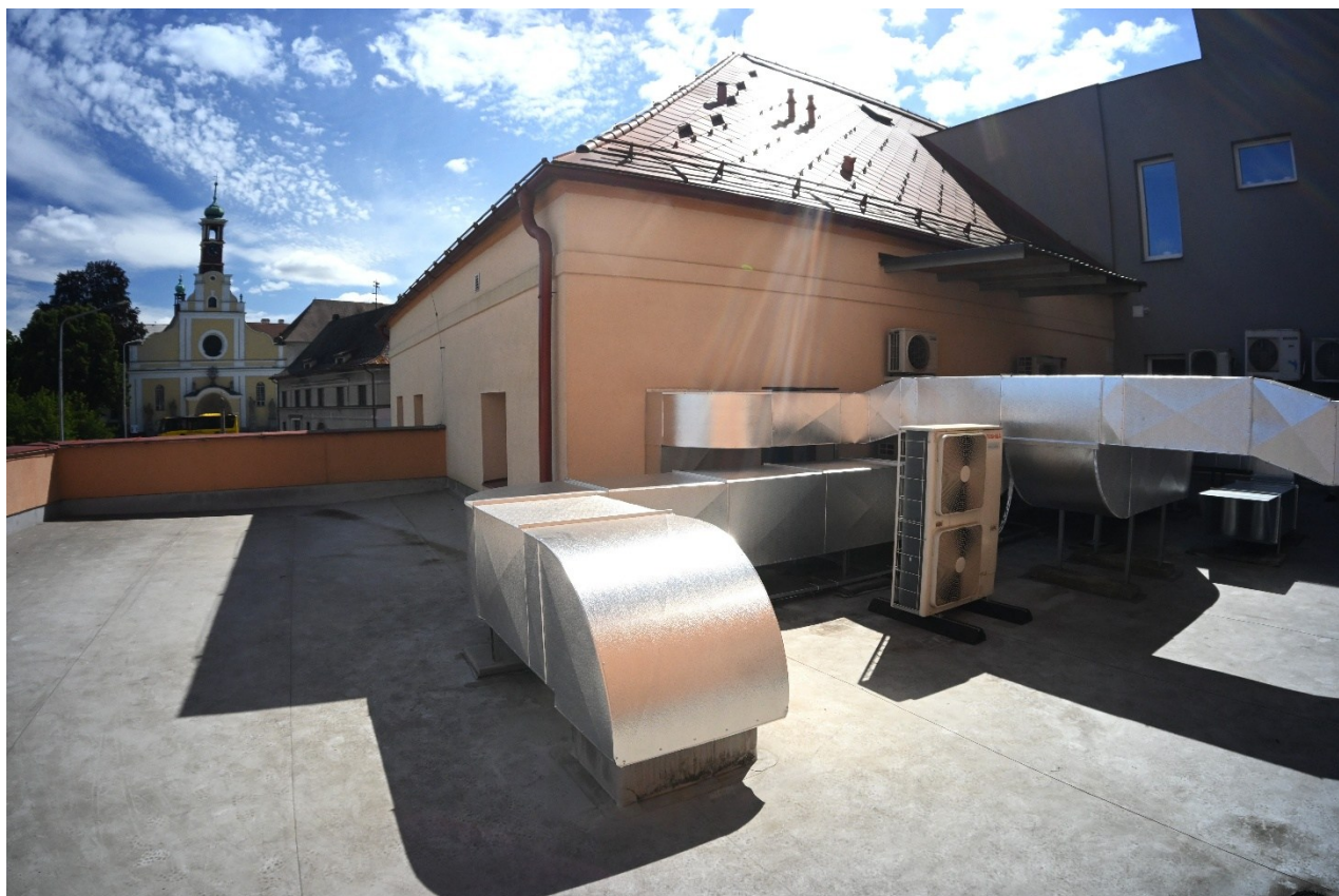
Obr. 4a, 4b – Finální vzhled vzduchotechniky na střeše ze dne 18.08.2025
