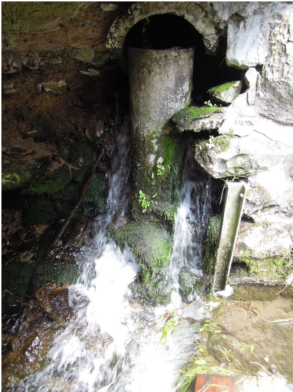
Obr. 3 – havarijný stav výústního objektu, květen 2025
